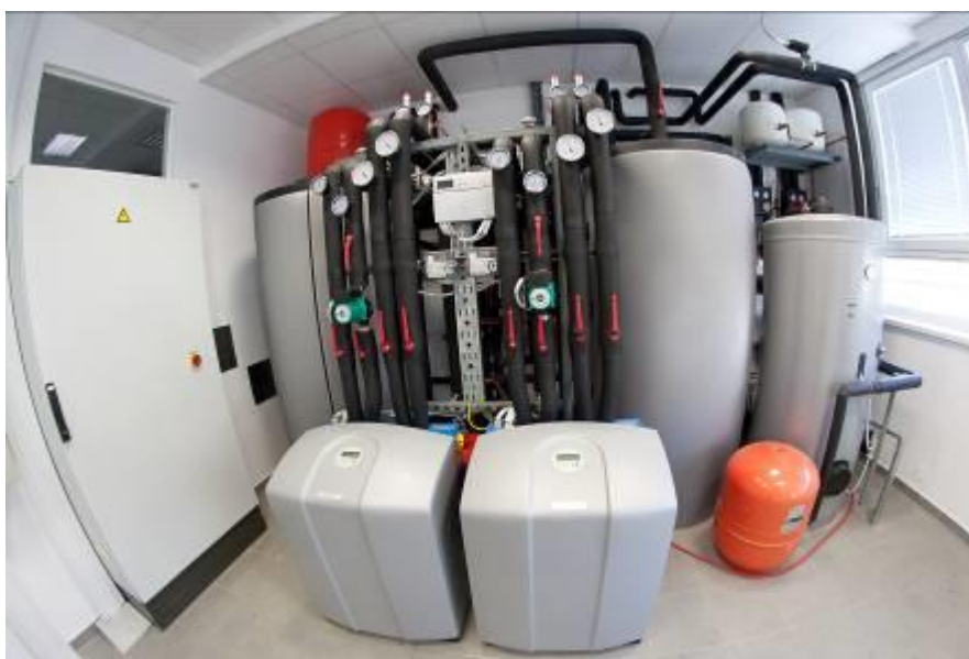
Obrázok 6.6: Kombinácia nádrže na teplú a studenú vodu, kotla a reverzibilného tepelného čerpadla v tepelnej stanici
